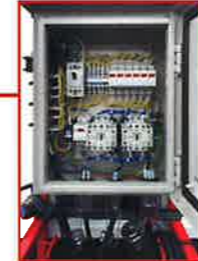
※操作盤内部にも電源スイッチ完備
