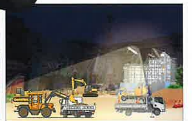
山奥のダム工事にて、現場を明るく照らす照明として活用しました。
